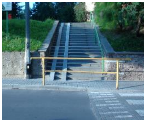
Fot. o.22 Zbyt wąski chodnik dodatkowo ograniczony barierką – osiedle Niepodległości przy ul. Andersa. (zdj. TransEko).
