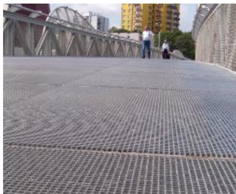
Fot. o.21 Kładka nad ul. Filaretów. Nawierzchnia nieprzystosowana np. dla osób w butach na obcasie. (zdj. TransEko).
