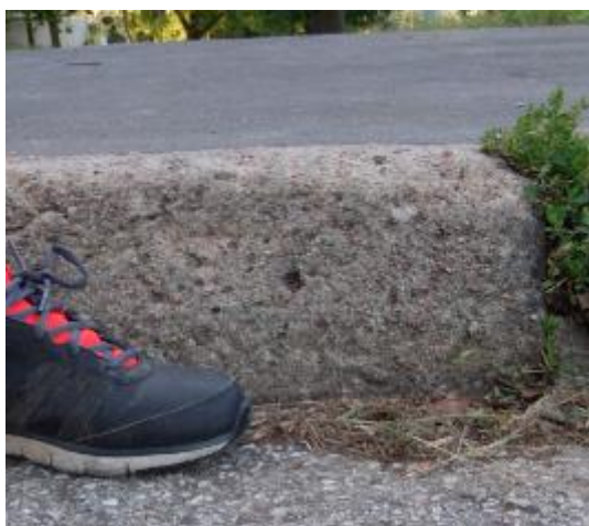
Fot. o.19 Krawężnik niedostosowany do potrzeb pieszych. (zdj. TransEko).
