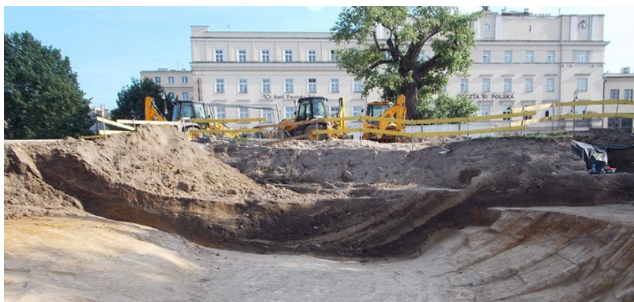
Perspektywiczne ujęcie na negatyw fosy, w tle – jej zasypyany odcinek (fot. P. Zimny) Perspective view on the negative of the moat, with backfilled section in the background
