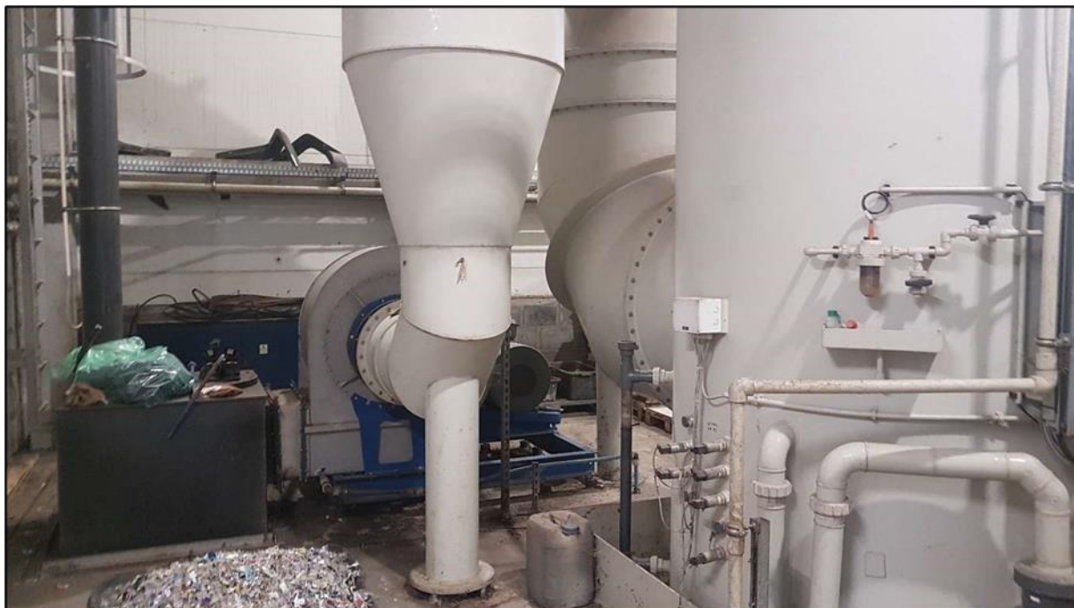
Rycina 13. Widok na wentylator napowietrzający/wyciągowy oraz płuczkę źródło: Analiza potencjału wydajnościowego dla instalacji BPO na terenie KOM-EKO S.A.
