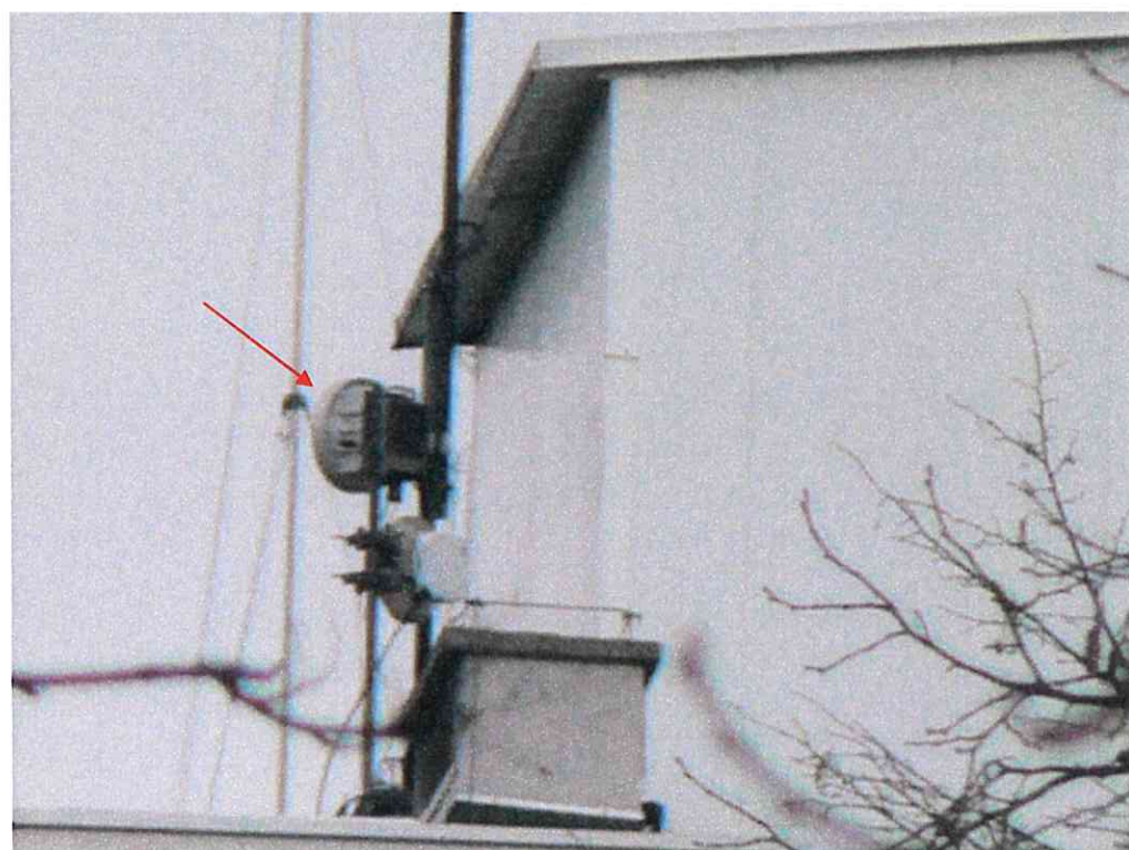
Widok instalacji radiokomunikacyjnej Stacja Netia LUBLB366 - LUBLM00253ANT003 Lublin, ul. Konrada Wallenroda 4C.
