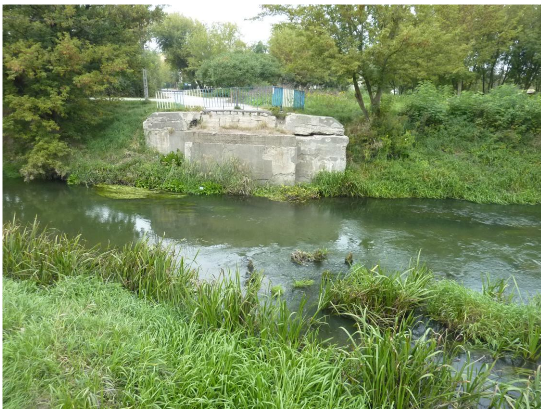
Ulica Azaliowa – widok miejsca po zdegradowanej kładce; Archiwum ABA
